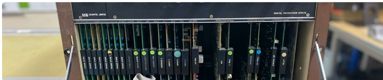
Fig. — Dans le châssis du DPE 5001P Plus : sept cartes « FRAME STORE » côte à côte, chacune une mémoire d'image complète.
